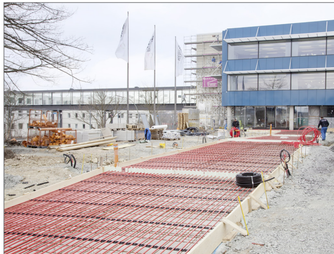
Obr. 15-2 Vytápění venkovních ploch – vyhřívání parkoviště
