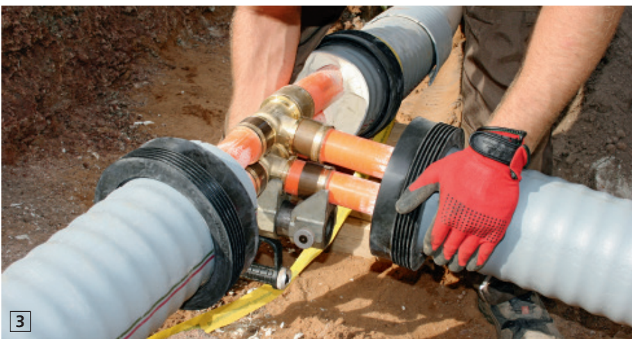
3 Sicherheit durch geprüfte Systemlösungen, bestehend aus optimal aufeinander abgestimmter Rohr- und Verbindungstechnik. (Fotos: Rehau)
