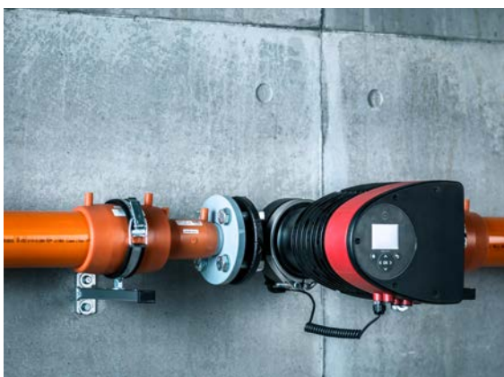
Fig. 05-1 Centrale de chauffage
