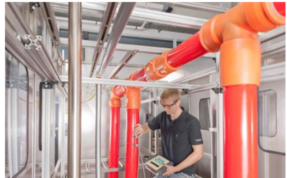
Fig. 06-21 Les tuyaux et la technique de raccordement sont testés comme un système
