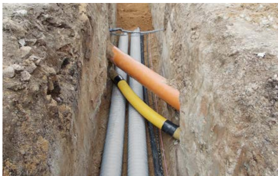
Fig. 07-22 Passage en dessous de câbles qui se croisent
