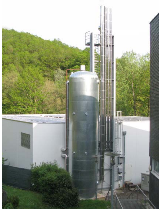
Fig. 06-8 Accumulateur de chaleur centralisé
