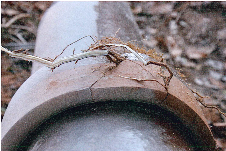
Abb. 11b: Zustand der Steinzeugmuffe bei Position 3,3m nach Aufgrabung
