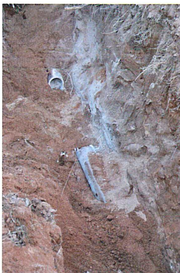
Abb.10: Herausgetrennter Bereich der Steinzeugleitung
