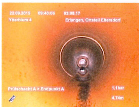
Abb.4: TV-Kamera Inspektion 2015 der Kunststoffleitung
