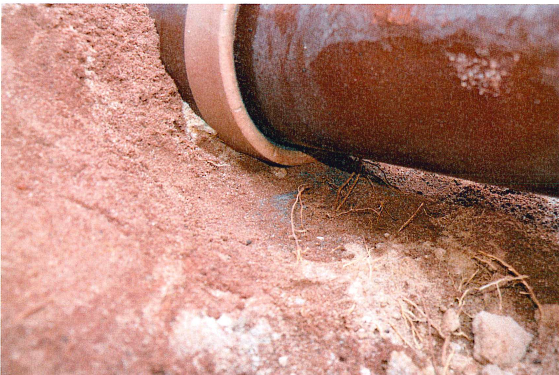
Abb.9 c: Zustand nach Aufgrabung Steinzeugleitung (Position der Muffe 3,3 m)
