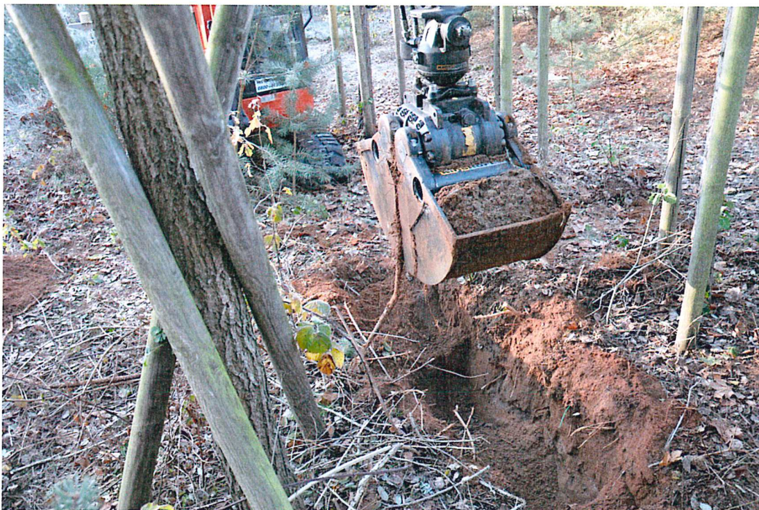
Abb.5: Zustand in der flachen Wurzellage zwischen Baum B4 und B7 der Kunststoffleitung
