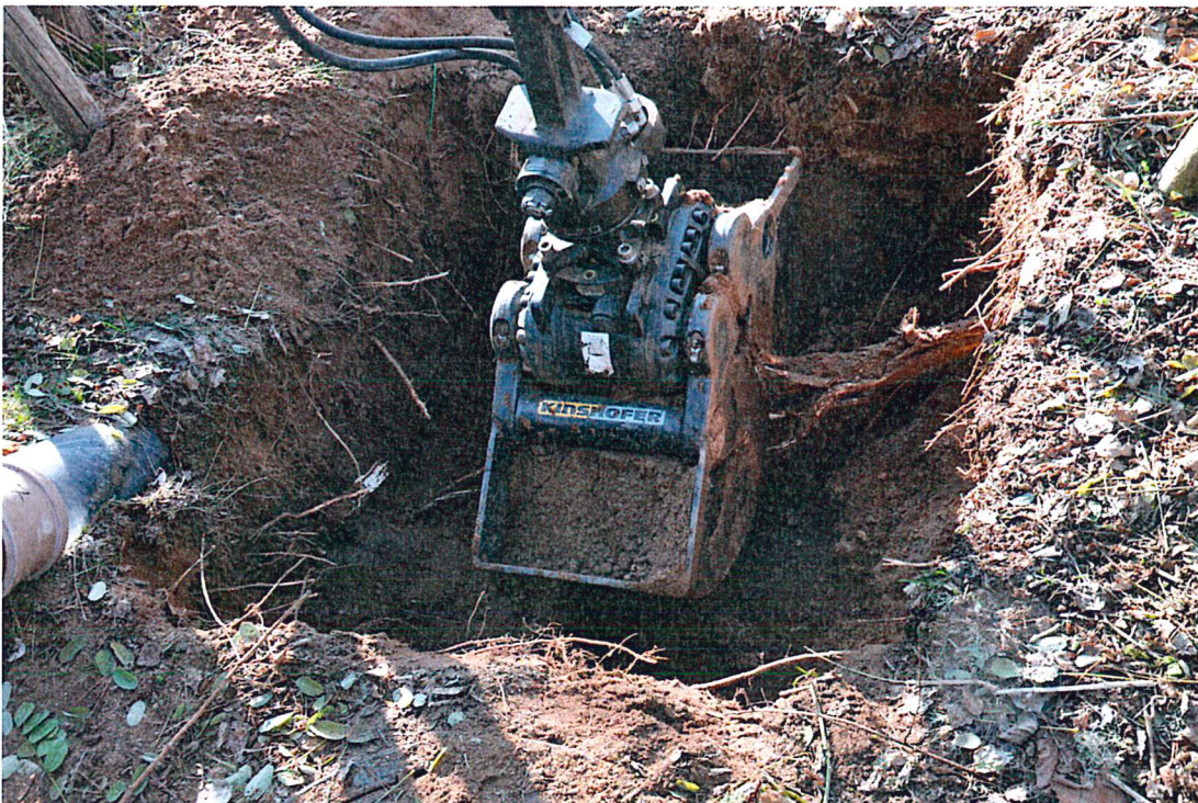
Abb.7: Zustand in der flachen Wurzellage zwischen Baum B1 und B7 der Steinzeugleitung
