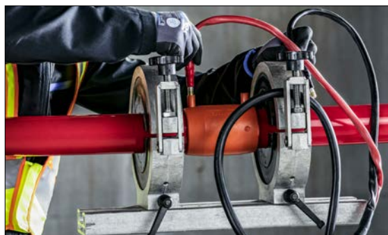
Abb. 03-16 Nach erfolgreichem Schweißvorgang ertönt ein akustisches Doppelsignal. Im Display erscheint „OK“. Die Stecker können entfernt werden.
