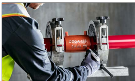
Abb. 03-18 Die persönliche Identifikationsnummer sowie aktuelles Datum auf der Elektroschweißmuffe mit Markierungsstift vermerken.
