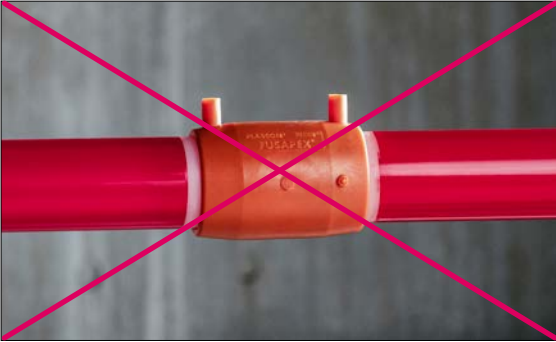
Abb. 03-28 Unvollständig eingesteckte Rohre nicht verschweißen.
