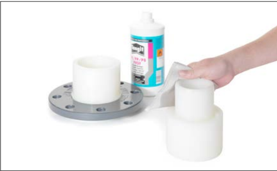
Abb. 03-31 Flansche und Reduzierungen müssen nicht geschält, aber in jedem Fall gereinigt werden. Der Mindestdurchmesser gemäß Tab 03-3 ist immer einzuhalten.
