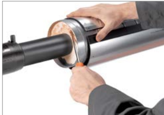
Abb. 47: 2. Die Stirnfläche des PUR-Hartschaumes mit einer Tiefe von ca. 10 mm auf beiden Seiten herausbrechen.
