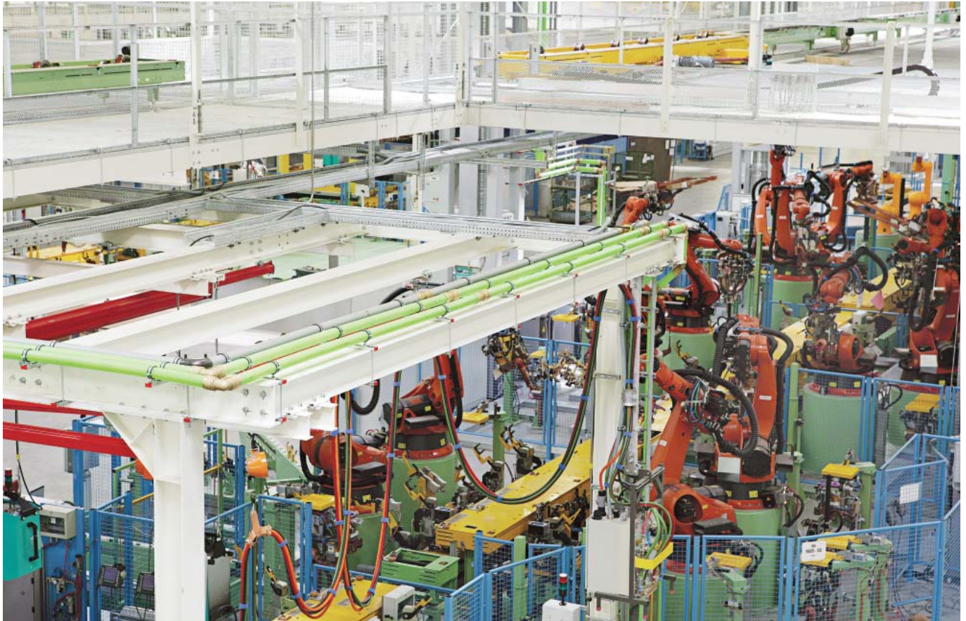
Daimler AG, Versorgung der Schweißroboter mit Druckluft und Kühlwasser
