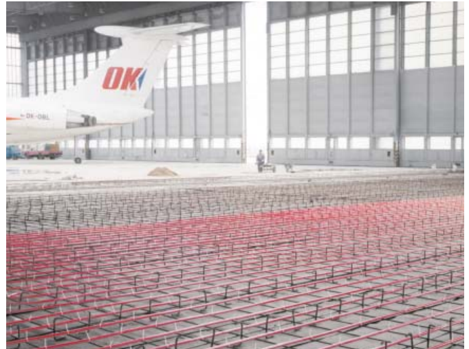
Die Industrieflächenheizung – ein modernes Heizkonzept für industriell genutzte Gebäude
