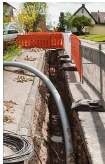
Bild 1. Erstmals wurde in Bonndorf mit RAUTHERMEX STRONG ein PMR-System für max. Betriebsdrücke bis 10bar installiert
