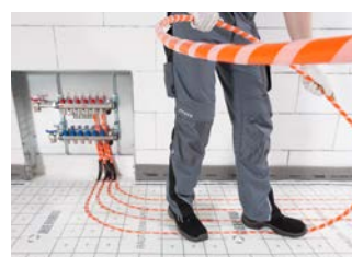
7 Vor- und Rücklauf des zweiten Heizkreises sowie Heizkreis selbst installieren. Nachfolgende Heizkreise wie vorab beschrieben nacheinander installieren.
