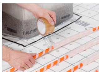
4 Die Enden des RAUTHERM iso Streifens auf der Heizkreisseite abkleben, so dass kein Estrichanmachwasser hineingelangen kann.
