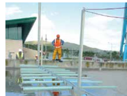
新西兰 Te Maunga 污水处理项目
