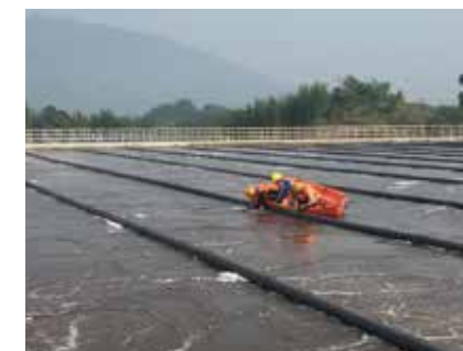
四川某造纸废水悬挂链项目
