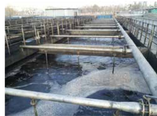
山西某焦化废水处理项目
