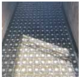
杭州七格污水厂,中国
