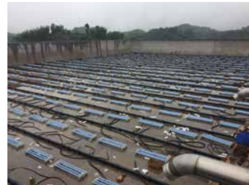
四川某造纸废水悬挂链项目
