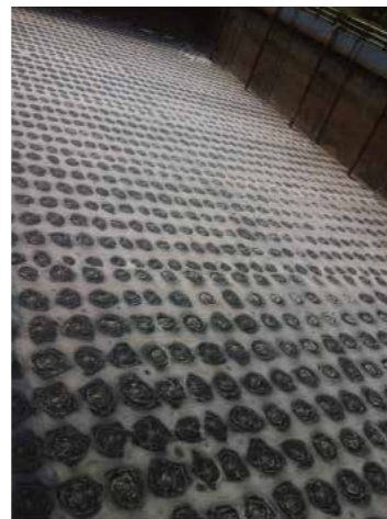
四川某再生水厂
