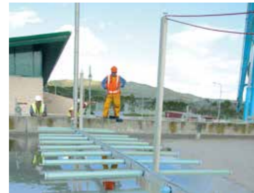
新西兰 Te Maunga 污水处理项目
