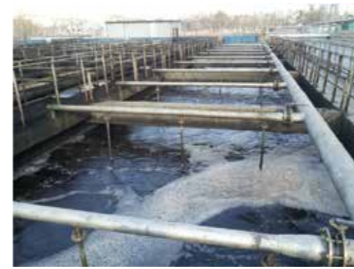
山西某焦化废水处理项目
