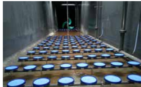
大亚湾某污水处理厂，中国
