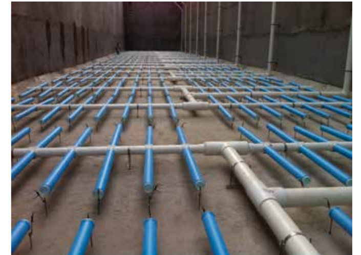
成都某污水处理厂
