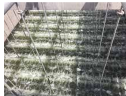
内蒙古乌海工业园废水处理项目
