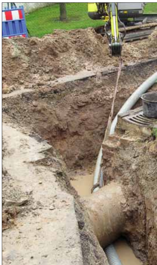
Bild 1. Um Ecken und Kanten: Aufgrund der Flexibilität der Kunststoffrohrleitungen können Hindernisse umgangen und Richtungsänderungen mit wenig Aufwand realisiert werden
