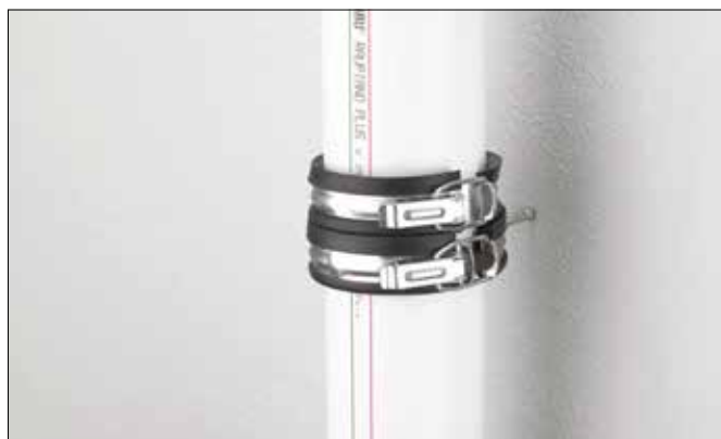
Rys. 6-3 Zainstalowany uchwyt tłumiący
