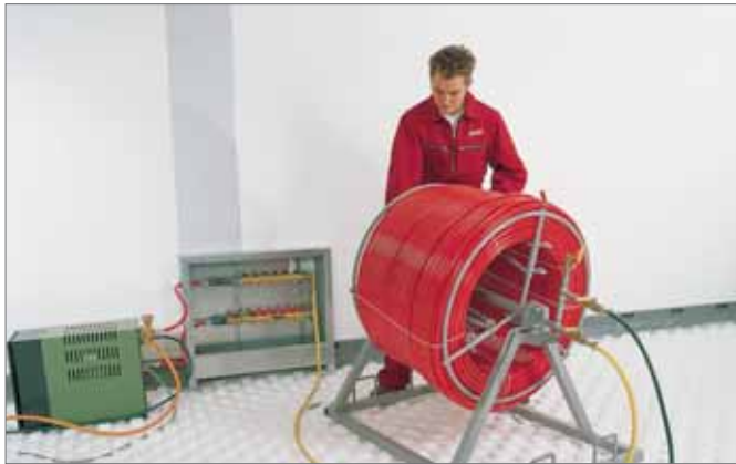
Fig. 8-9 Desbobinador en caliente REHAU
