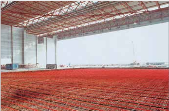
图31-1 工业大厅中的地板采暖系统
