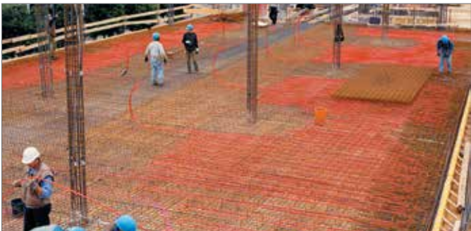
图30-5 现场安装的瑞好结构采暖和制冷系统
