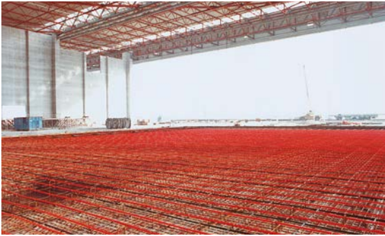
Abb. 06-1 Flächenheizung in einer Industriehalle
