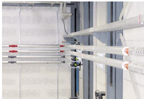
Transport von Wärme und Kälte zur Klimatisierung eines REHAU Verwaltungsgebäudes
