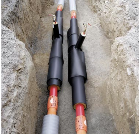
Wärmeversorgung eines Krankenhauskomplexes in La Roche-sur-Yon (Frankreich) mit RAUTHERMEX
