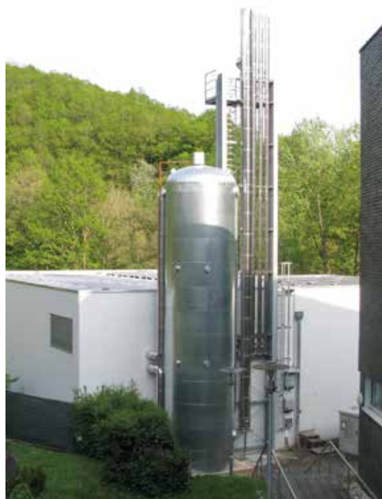
Fig. 06-8 Generatore di calore centrale
