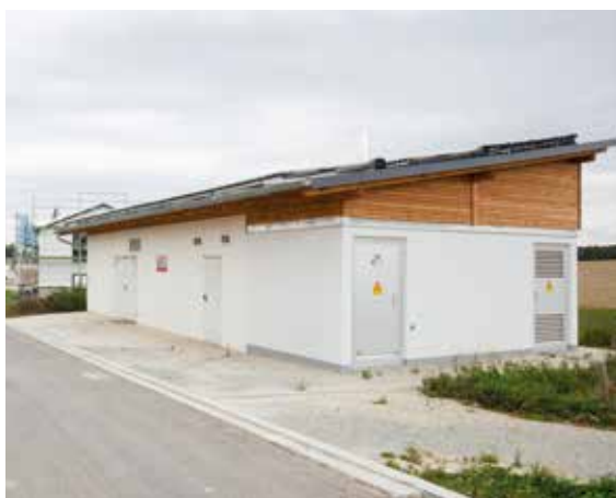
Fonte di calore / centrale termica
