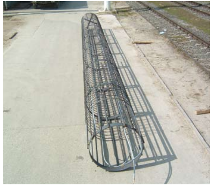
Fig.14: Pilastrino di fondazione con sonde integrate RAUGEO
