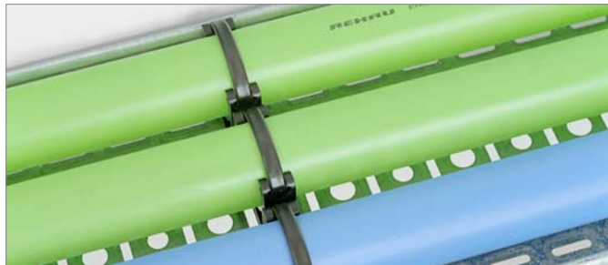
130. ábra RAUPEX csövek kábeltartó rendszerre fektetve
