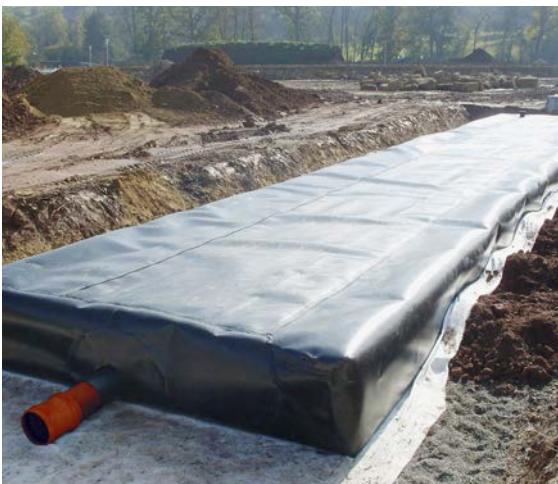
Regenwasserspeicher mit Folienummantelung
