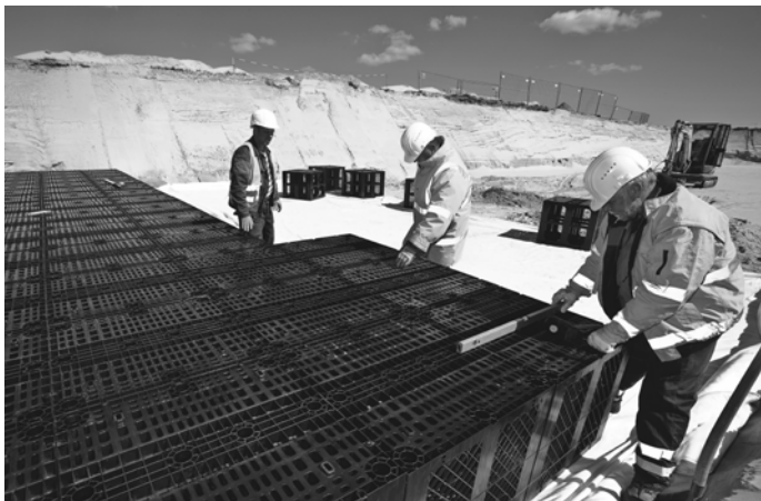
Installazione di celle RAUSIKKO
