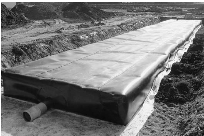
Zbiornik retencyjny osłonięty folią
