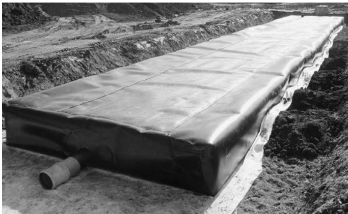
Regnvattentank med foliebeläggning
