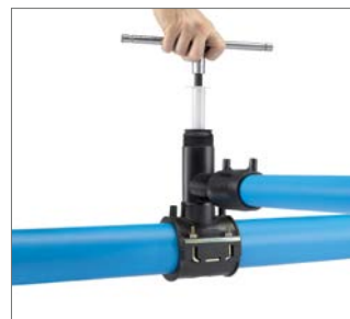
Abb. 62 10. Nach Durchbruch der Leitung das Locheisen gegen den Uhrzeigersinn bis zum Anschlag zurückschrauben.
