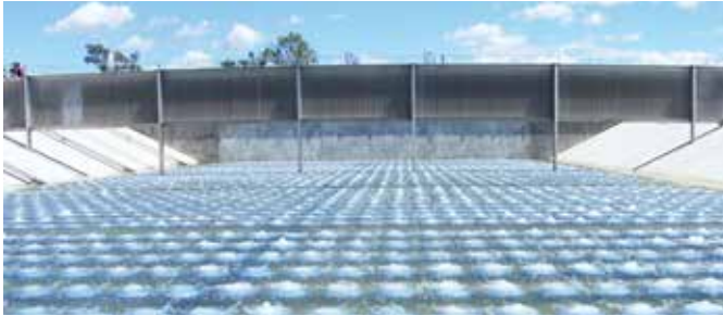
Tamworth STP (Australia)
