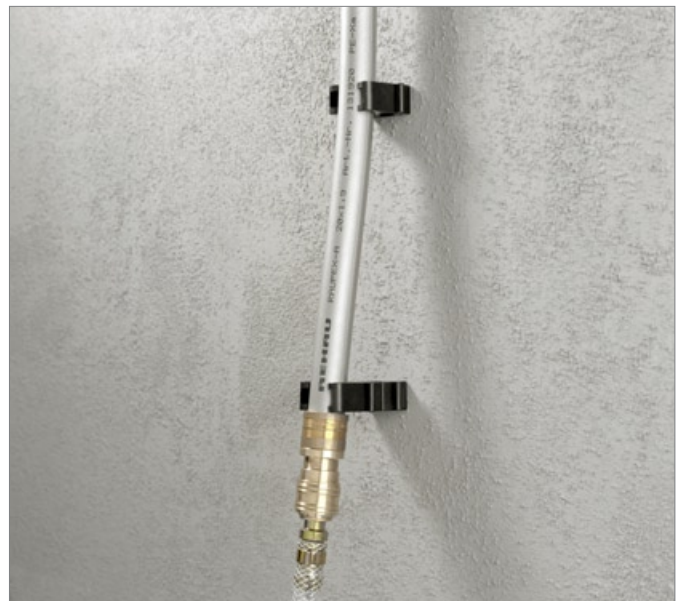
Abb. 36: Druckluft-Abnahmestelle mit Schnellkupplung
