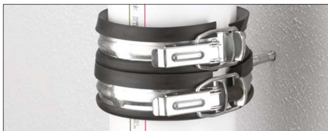
Fig. 3-6 Kompletterat installerat ljuddämpande stödfäste
