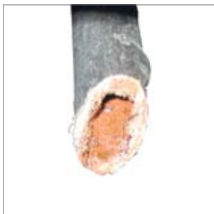
Accumulation de corrosion dans les conduites en métal
