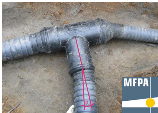
Rys. 11 Odchylenie kątowe pomiędzy rurą a złączką
