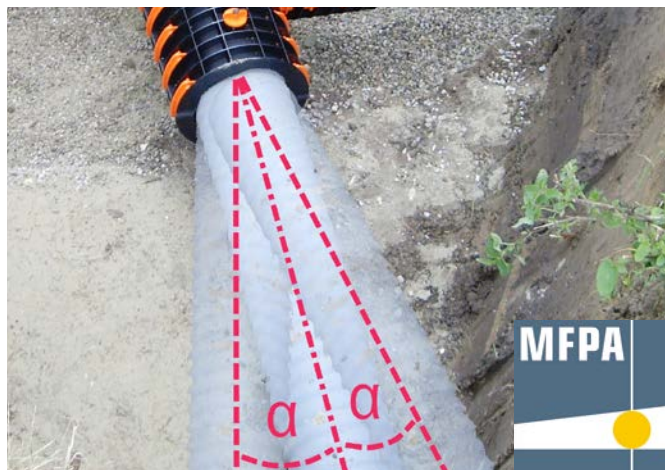
Rys. 9 Odchylenie kątowe pomiędzy rurą a złączką
