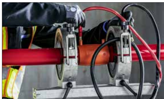
Fig. 03-16 Un doppio segnale acustico indicherà la fine del processo di saldatura, il display indica "OK". A quel punto i cavi potranno essere estratti.
