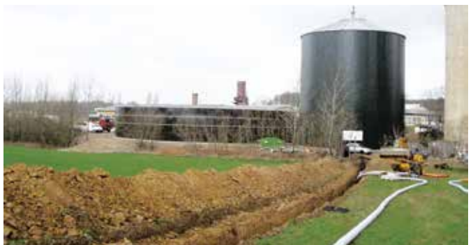
Fig. 1-6 Installation de production de biogaz.
