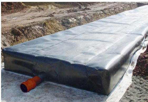
Bacino di accumulo per acque meteoriche con membrana di rivestimento
