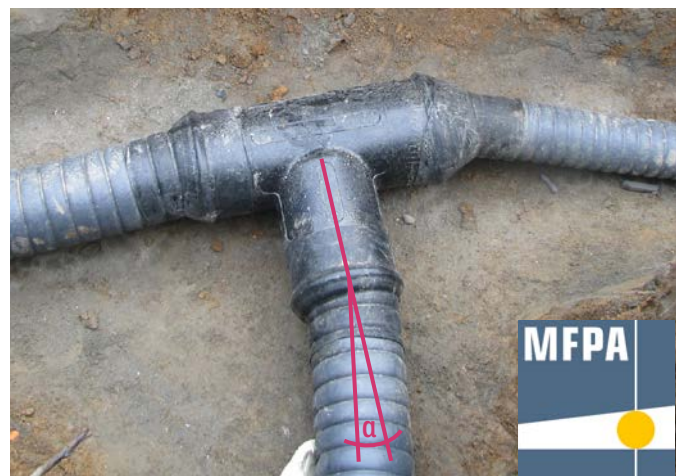
Abb. 15 Winkelabweichung zwischen Rohr und Muffe
