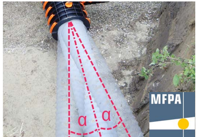
Abb. 13 Winkelabweichung zwischen Rohr und Muffe
