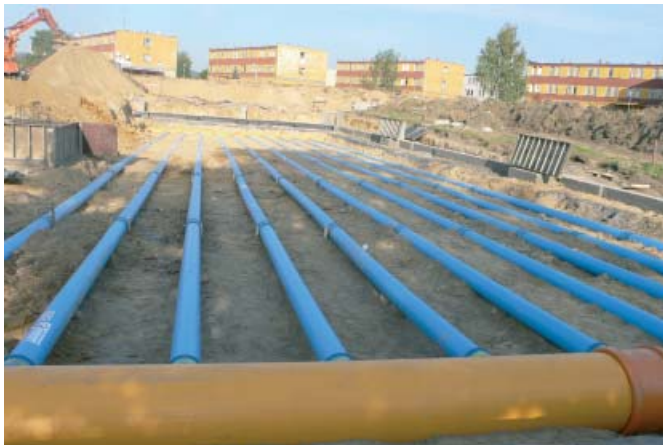
Luft-Erdwärmetauscher im Tichelmannsystem
