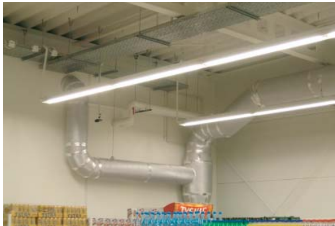
Verbindung Luft-Erdwärmetauscher/ Lüftungszentrale
