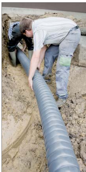
Transporte eficiente desde la fuente de calor al edificio
